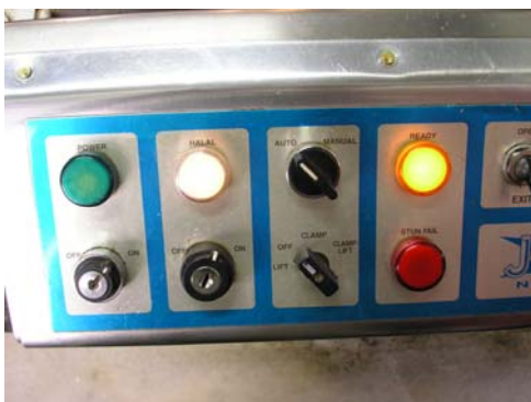
Bild 13. Manöverpanelen skall tydligt indikera om problem uppstått.
